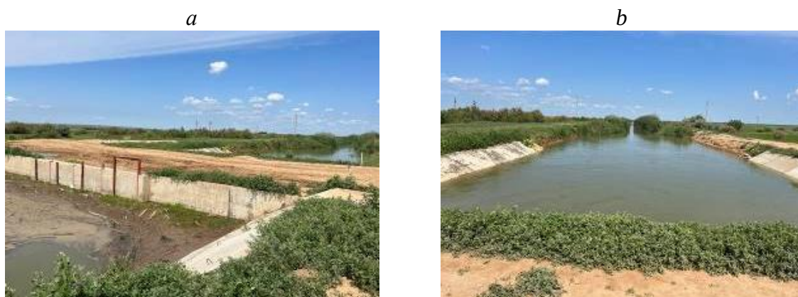
a – засорение и заиливание приемной камеры в верхнем бьефе водовыдела на Черноземельском магистральном канале; b – нижний бьеф сооружения (Гашунский распределительный канал)
