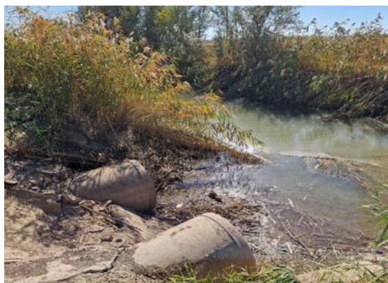
Водовыпуск в межхозяйственный канал на ПК 255
