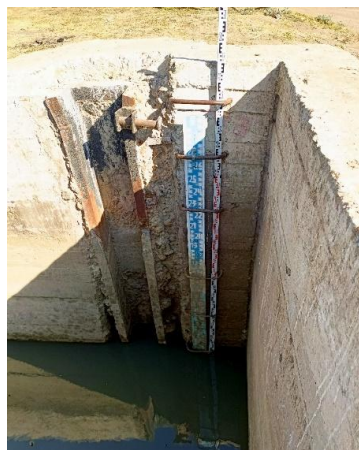
Рейка на входном оголовке дюкера Rack on the inlet head of the siphon
