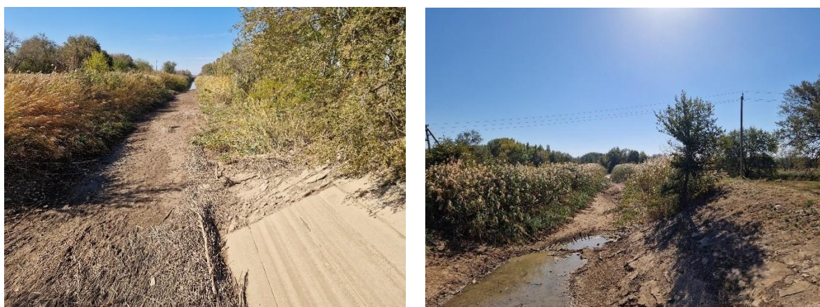
Рисунок 3 – Заиление и зарастание Азовского магистрального канала (автор фото В. Д. Гостищев)
