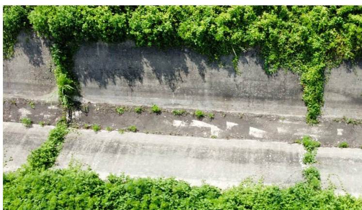
Рисунок 3 – Нарушение герметичности деформационных швов (автор фото В. Г. Дегтярев)
