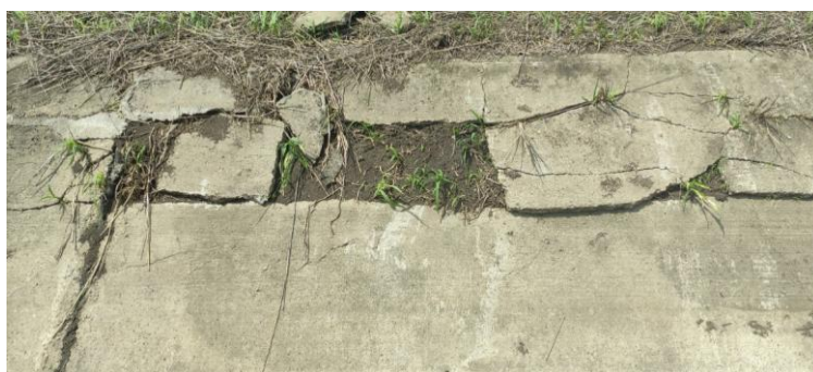
Рисунок 2 – Локальное разрушение бетонной облицовки канала (автор фото В. Г. Дегтярев)
